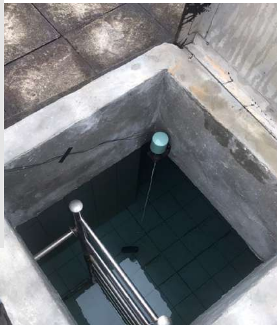
/ 頂樓水塔與加裝無線橋接通報器
